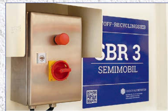
Schaltschrank mit Betriebsstundenzähler
