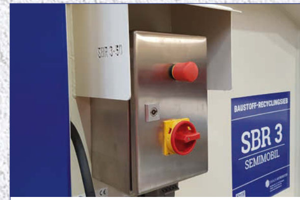
Schaltschrank mit Betriebsstundenzähler
