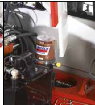
Mengengesteuerte Zentralschmieranlage mit Leerstandsmeldung
